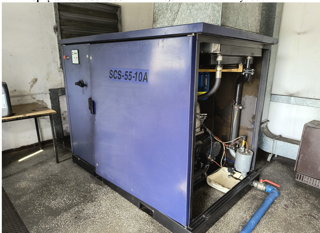
22. Sprężarka śrubowa 55 kW. P= 10,0 bar. Rok budowy 1997.
